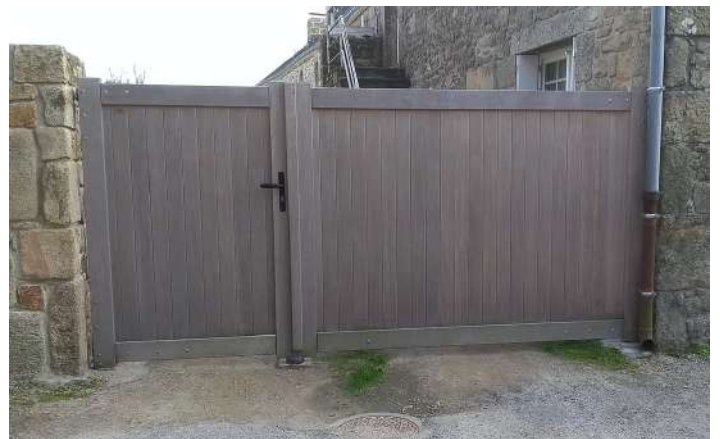
Portail EV301 en Sipo - vantaux inégaux 13 mois plus tard (photo de droite)
